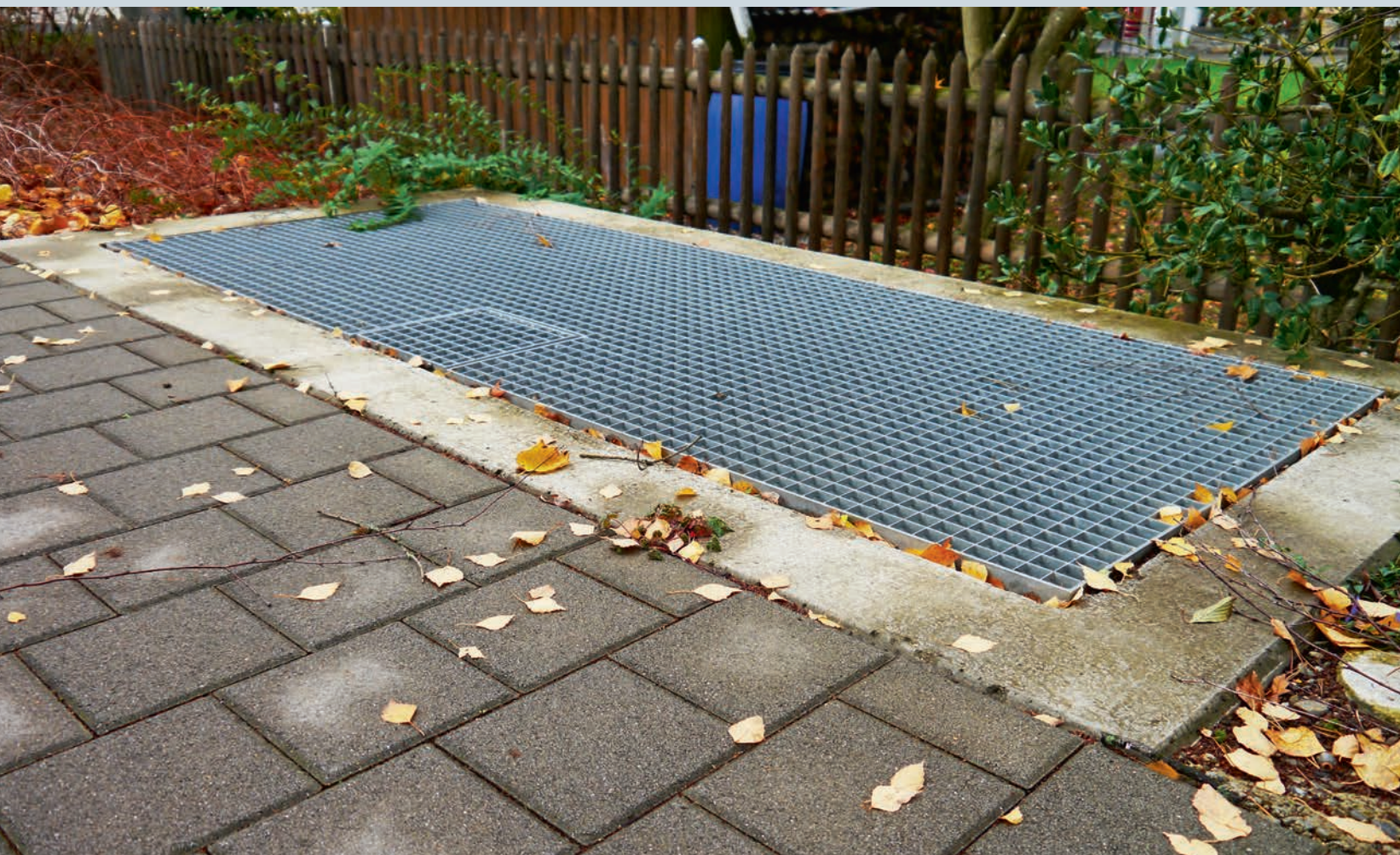
Der liegende Gitterrost: Er gewährt im Alltag die Entlüftung der Tiefgarage.
